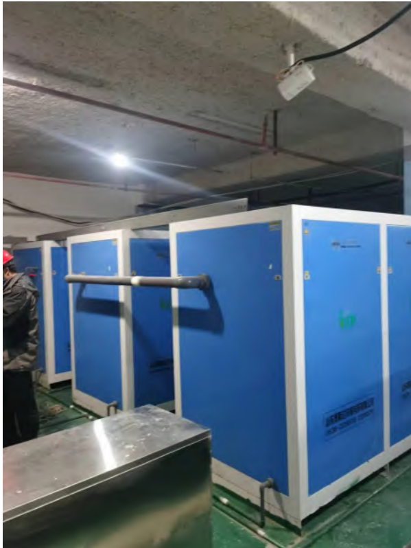
实验室污水处理设施一体化设施
