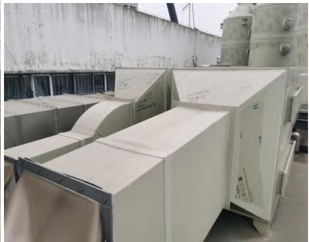
P4 有机废气活性炭处理设施
