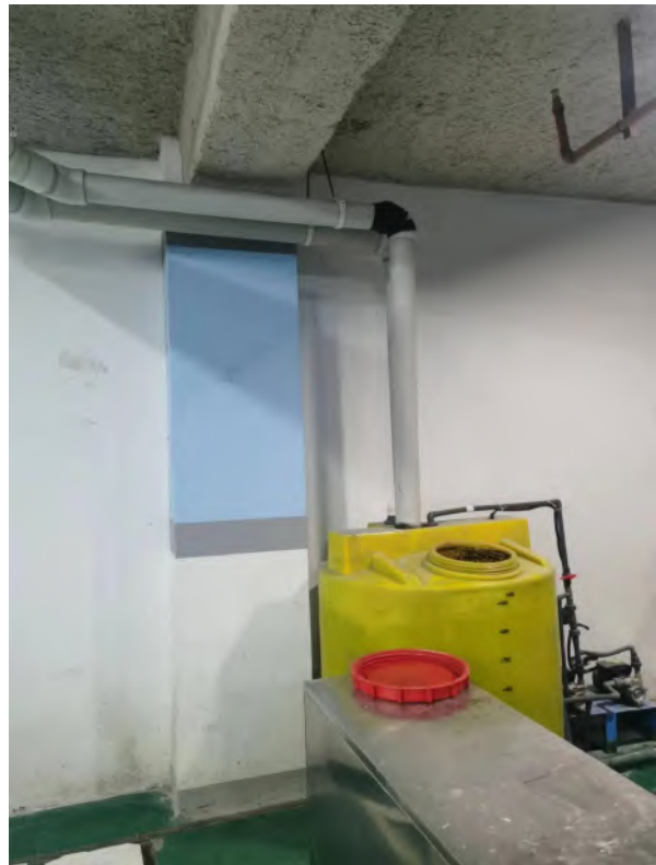
实验室废水处理设施进水罐
