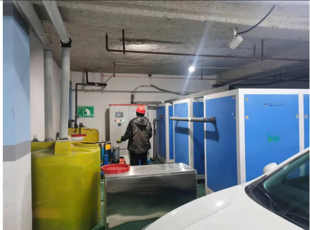
实验室自建废水一体化处理设施
