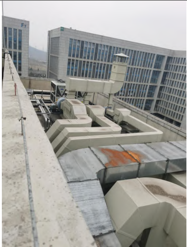
P3 有机废气处理设施
