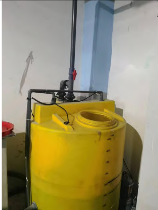
实验室废水处理设施出水罐
