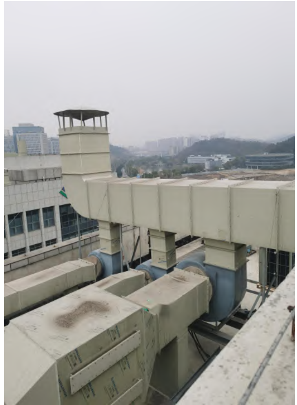
P2 有机废气处理设施
